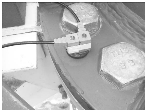
Hình 9.2. Bố trí đầu đo dao động trên mặt bích nối đốt thanh cánh
